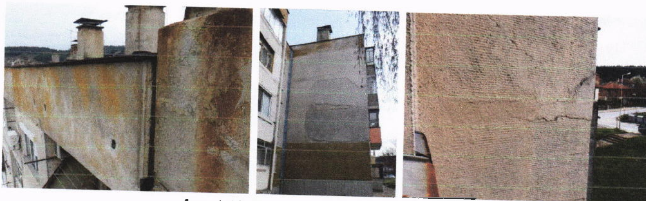
Фиг. 1.10. Нарушения по външните стени
